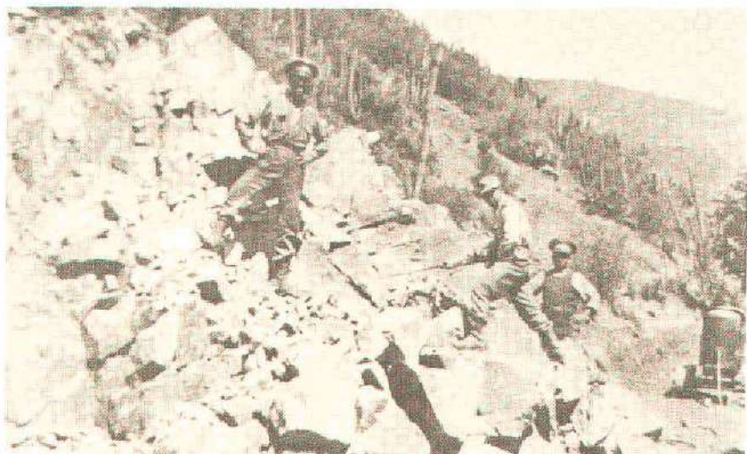
Tropas de Ingenieros en la obra de corte de camino en Pichel, en marzo de 1945.
